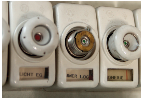
Abb. 8: Lebensgefährlicher defekter Sicherungskopf
