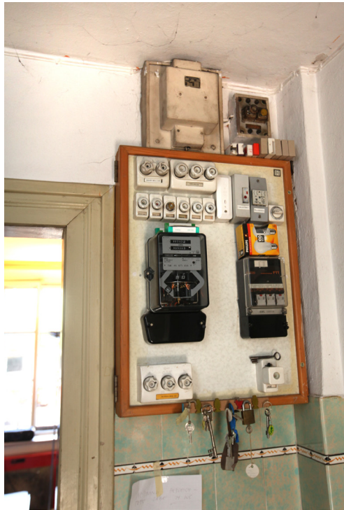
Abb. 2: Nicht mehr zeitgemässe Elektroverteilung
