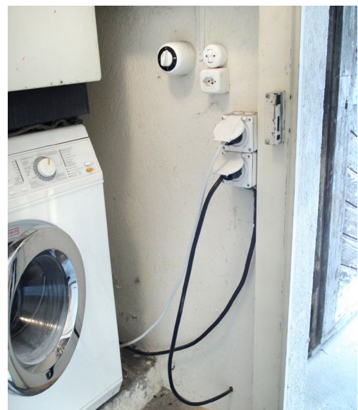
Abb. 4: Ortsveränderliche Leitungen dürfen nicht durch Wände geführt werden
