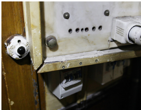
Abb. 6/7: Asbestverkleidung in einer veralteten Elektroverteilung
