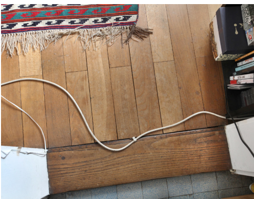
Abb. 1: Ortsveränderliche Leitung bei einem Durchgang
